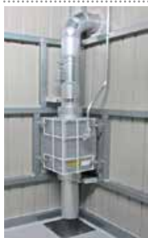
中間ダクトファン (ガード付) 防火ダンパー
